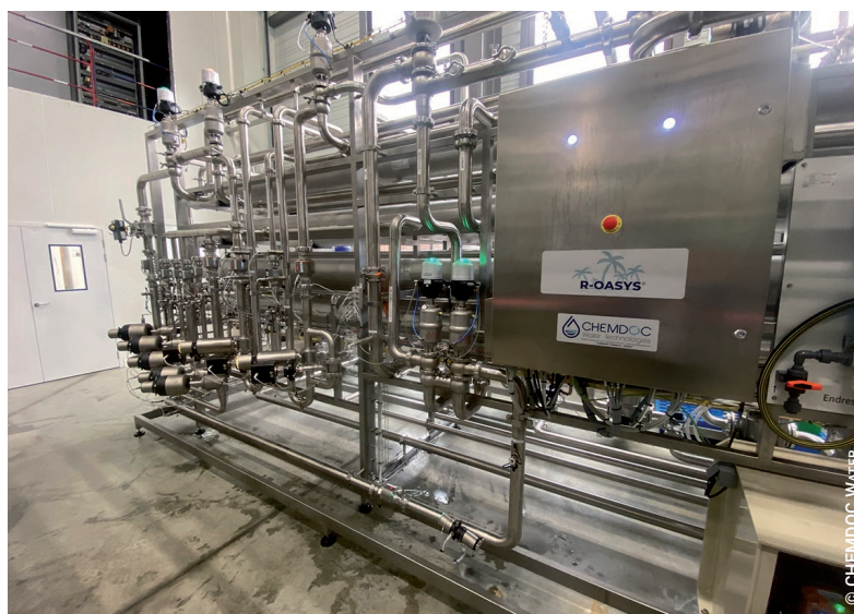
Unité R-Oasys de recyclage avancé de 24 m³/h intégrant 3 étages : MF, Nano et osmose inverse
